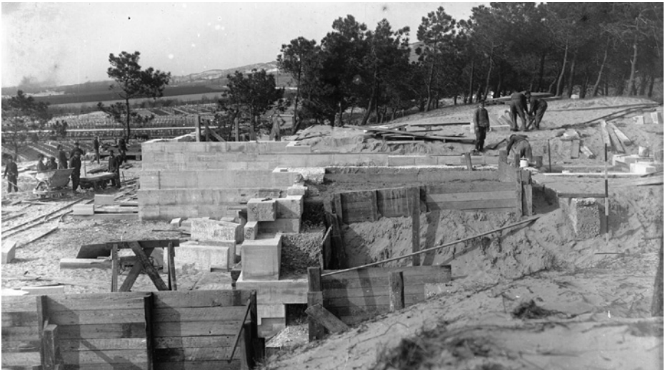
Construction du monument commémoratif du cimetière britannique d'Etaples Building of the memorial at the British cemetery Bouw van het herdenkingsmonument van de Britse begraafplaats van Etaples
